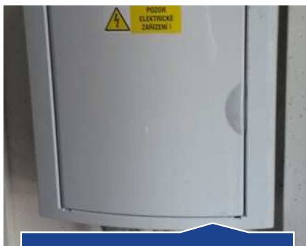
Rozvaděč rekuperačního systému
